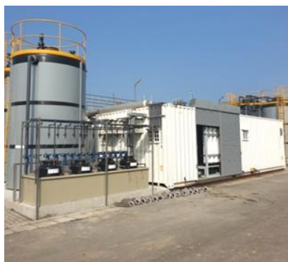
圖 12 RO 淨水設備
