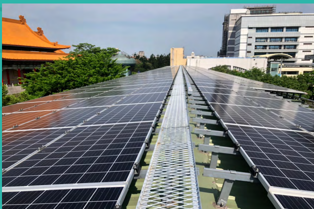
屋頂太陽能光電系統
