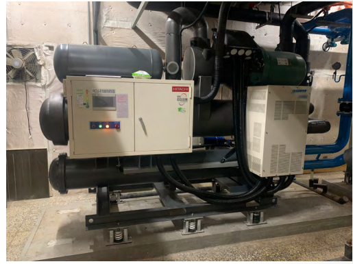
第二教研大樓冰水主機更新
