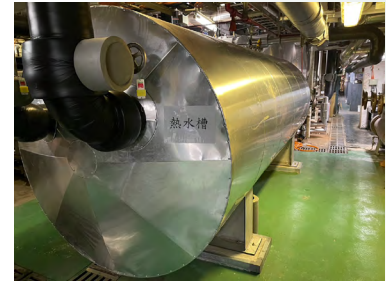
熱泵主機熱水系統
