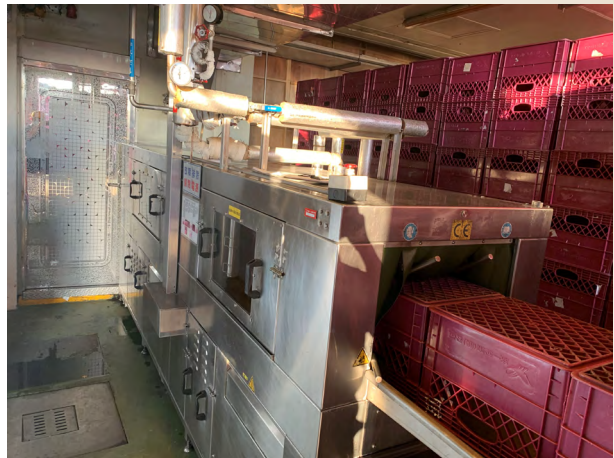
洗箱機能耗改善
