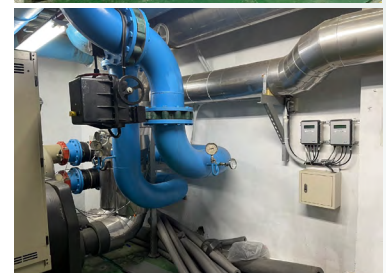
冰水主機空調系統
