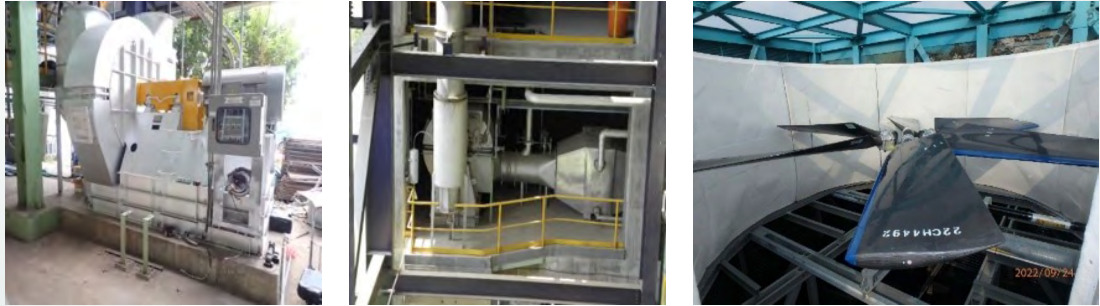
燃燒空氣送風機、誘引抽風機、冷卻水塔馬達變頻控制
